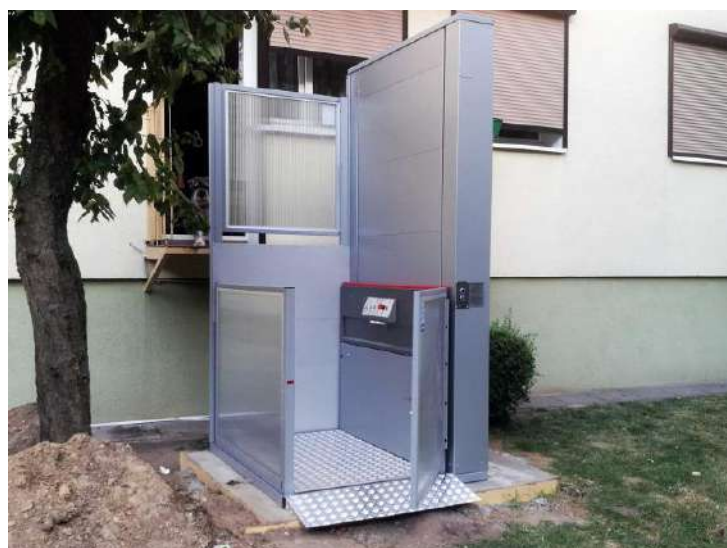
Podnośnik na dolnym przystanku w wersji przelotowej.
